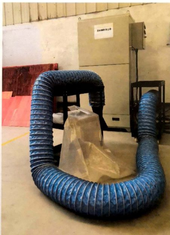
图 2-6 切割粉尘收集设施
